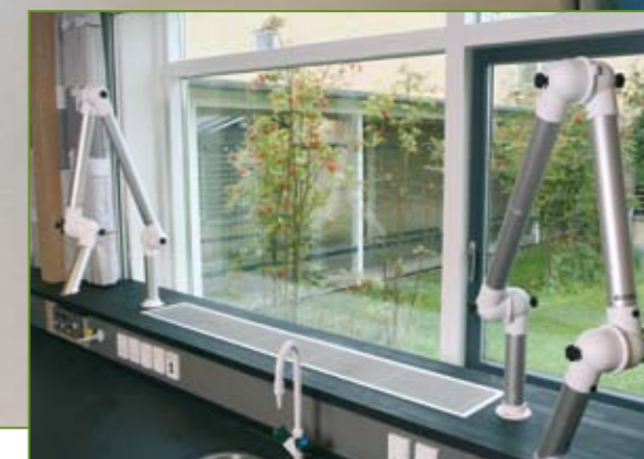
▲ Elevarbejdspladser langs vinduesparti med installationskasse for vand, el og gas og IT. Bemærk afdækningsrist for radiator.
